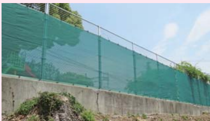
雑所でも職人の取付は仕上がりが違います。
